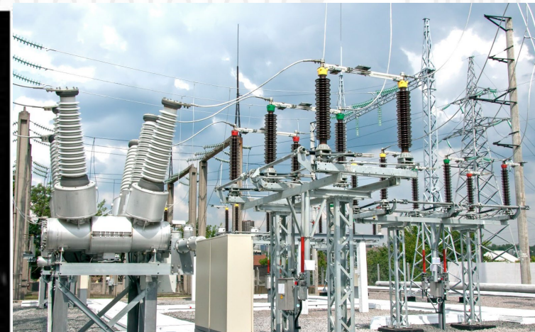
電力システムの安定化
